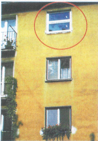
Vgradnja oken je lahko napačna že v izhodišču; prikazani primer je bolj za rubriko »saj ni res, pa je«.
