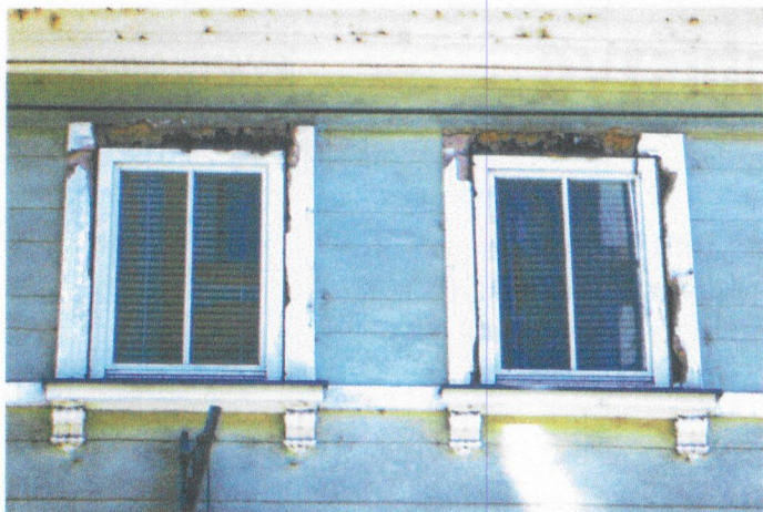
Primer neustrezne vgradnje in izvedbe tesnjenja pri zamenjavi oken.
